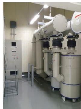
↑屋内を陽圧に保ち、汚染された外気を浄化する「フィルトリングシステム」
