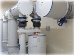
↑外気を浄化して取り入れるためのフィルタリング装置
