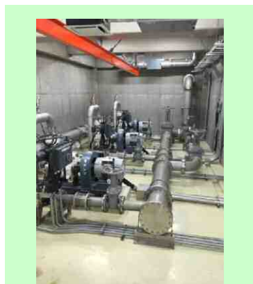
水道管理所 送水ポンプ（H21設置）
