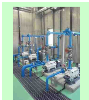
落合川浄水場 送水ポンプ（H26設置）
