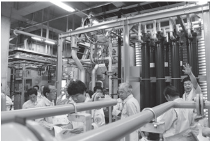
丹生・竹波簡易水道膜ろ過施設
