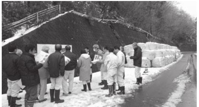
法面崩壊現場(町道金安線雲谷地係)
