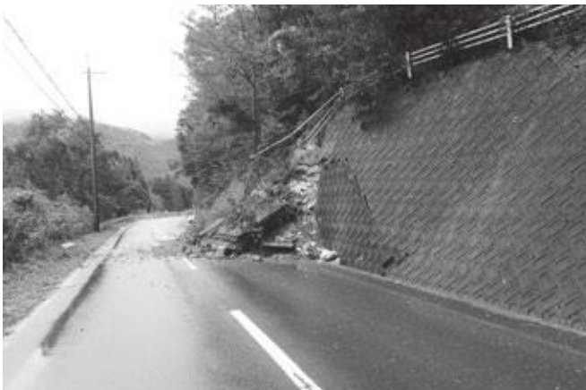
法面崩壊(町道金安線雲谷地係)
