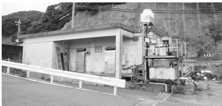
老朽化が進む冷凍・冷蔵設備（丹生漁協）
