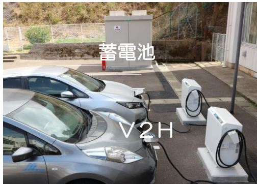
(写真奥) 蓄電池：容量16.2kWh、出力20kW (写真手前) V2H：容量30kWh、40kWh、出力6kW/台
