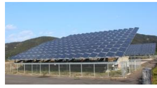
出力100kW (1基50kW)
