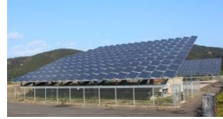
出力100kW(1基50kW)
