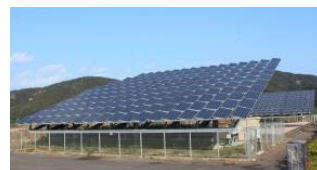
出力100kW (1基50kW)
