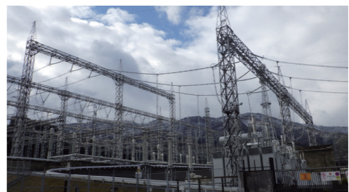
↑ 関西電力送配電（株）嶺南変電所（新庄）
