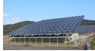
出力100kW (1基50kW)
