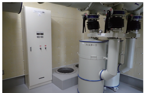
↑フィルタリングシステム制御盤（左）と放射性物質を除去するフィルター（右）
