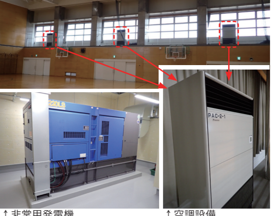
↑非常用発電機 ↑空調設備
