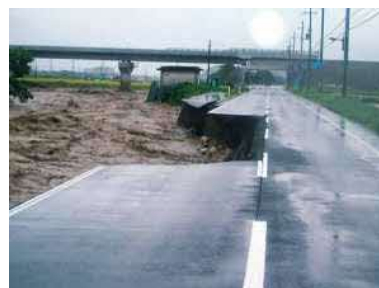
特別警報が発表された平成25年台風18号による町内での被害（耳川・県道松屋河原市線）
