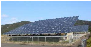
出力100kW(1基50kW) 一般家庭で使用する電力量300kWh/月として、約34軒分の電力量を発電しました。
