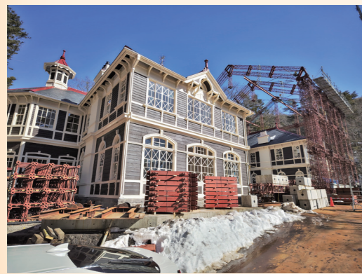
↑修理工事中の旧三笠ホテル (2月現在、令和7年初夏公開予定)
