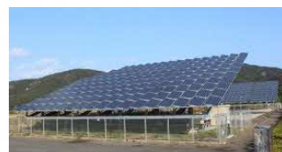
出力100kW (1基50kW)
