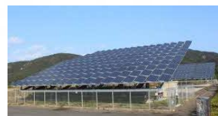
出力100kW (1基50kW)
