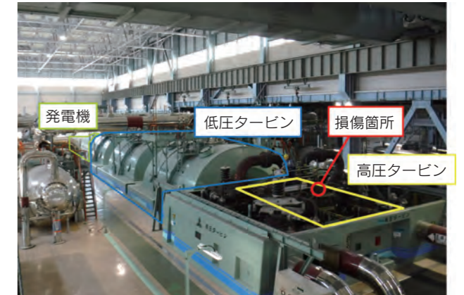
↑タービン建屋内の現地写真
