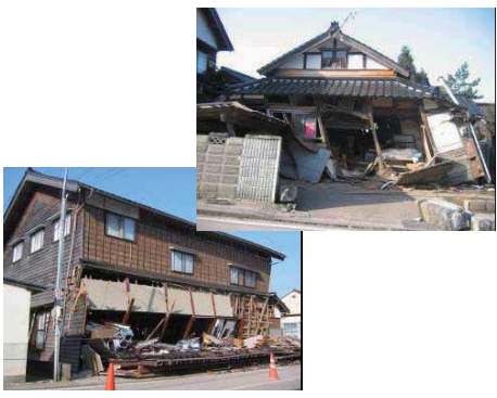
能登半島地震により倒壊した家屋 気象庁 HP より
