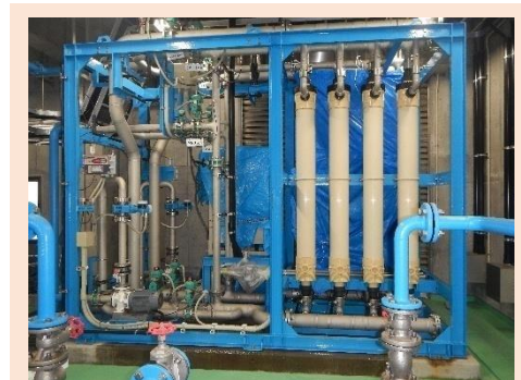
落合川浄水場膜ろ過装置
