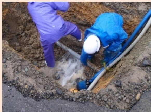
配水管からの漏水状況
