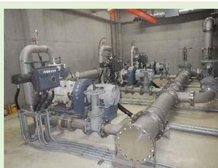
水道管理所送水ポンプ (H21 設置)
