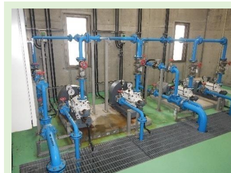
落合川浄水場送水ポンプ (H26 設置)
