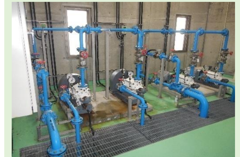
落合川浄水場送水ポンプ (H26 設置)
