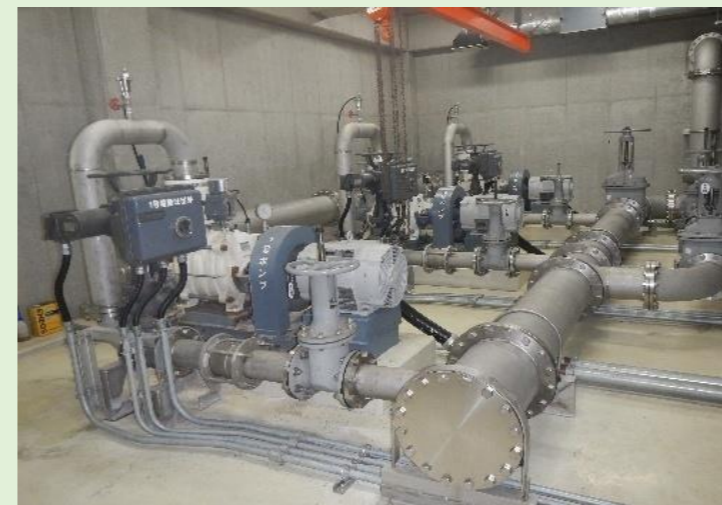
水道管理所送水ポンプ (H21 設置)
