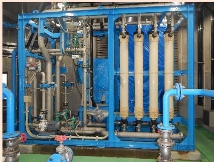
落合川浄水場膜ろ過装置
