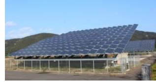
出力100kW (1基50kW)
